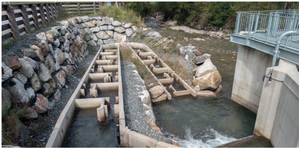
Foto 7: Technische Fischwanderhilfe in Form eines „Vertical Slot Fish Pass“ beim Kraftwerk Hermann & Müller KW an der Fuscher Ache
